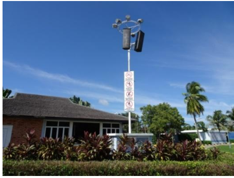
Gambar 31 : Flood light dipasang untuk tujuan pencahayaan utama kepada kawasan rekreasi di Taman Perdana Tg. Aru Kota Kinabalu.
